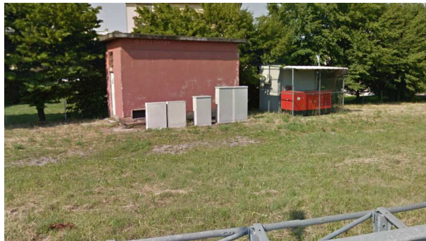
Cabina Zona Miranese
