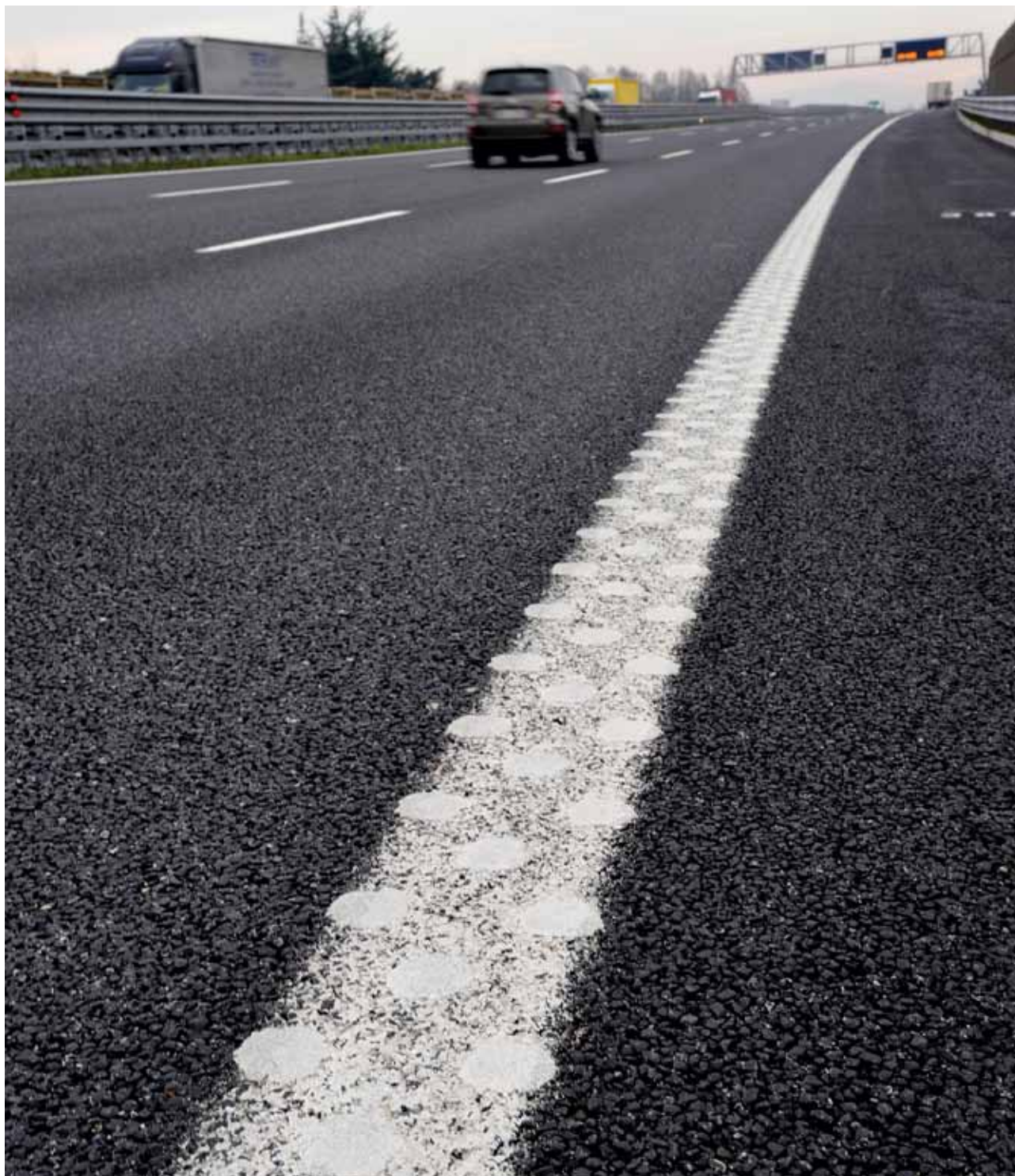
A4 – Passante di Mestre. Misure di sicurezza. Le “bolle” che caratterizzano la linea di separazione delle corsie di marcia dalla corsia di emergenza: un ulteriore accorgimento di sicurezza che segnala l’eventuale superamento del limite destro della corsia di marcia regolare.
